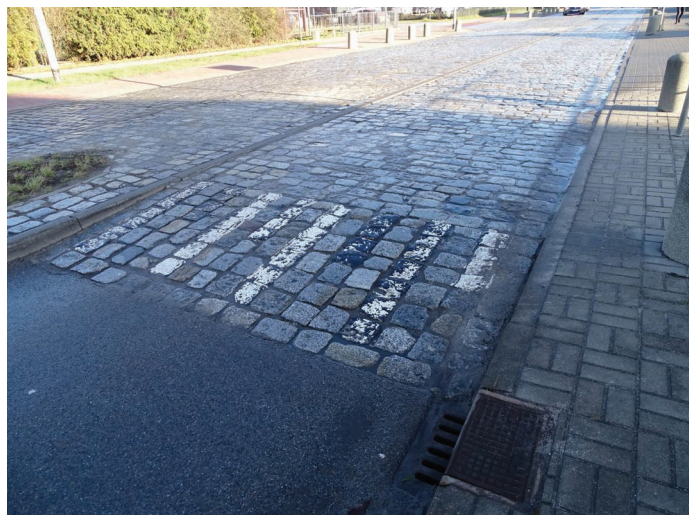
7. Oznakowanie poziome z mas termoutwardzalnych koloru białego zastosowane na rampach na wyniesione skrzyżowanie (Fot. Stanisław Majer)
