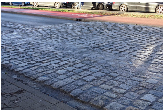
20. Osiadania nawierzchni w pobliżu ramp wjazdowych i zjazdowych (Źródło: opracowanie własne)
