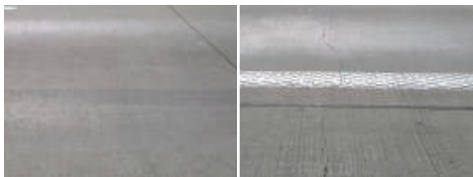
3. Autostrada A4 – nawierzchnia dyblowana (z lewej) oraz o ciągłym zbrojeniu (z prawej)
