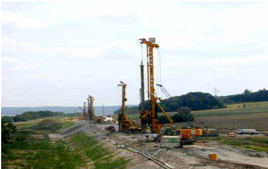
5. Wbijanie pali na linii kolejowej relacji Norymbergia – Ingolstadt dla nawierzchni szynowej bezpodсыpkowej
