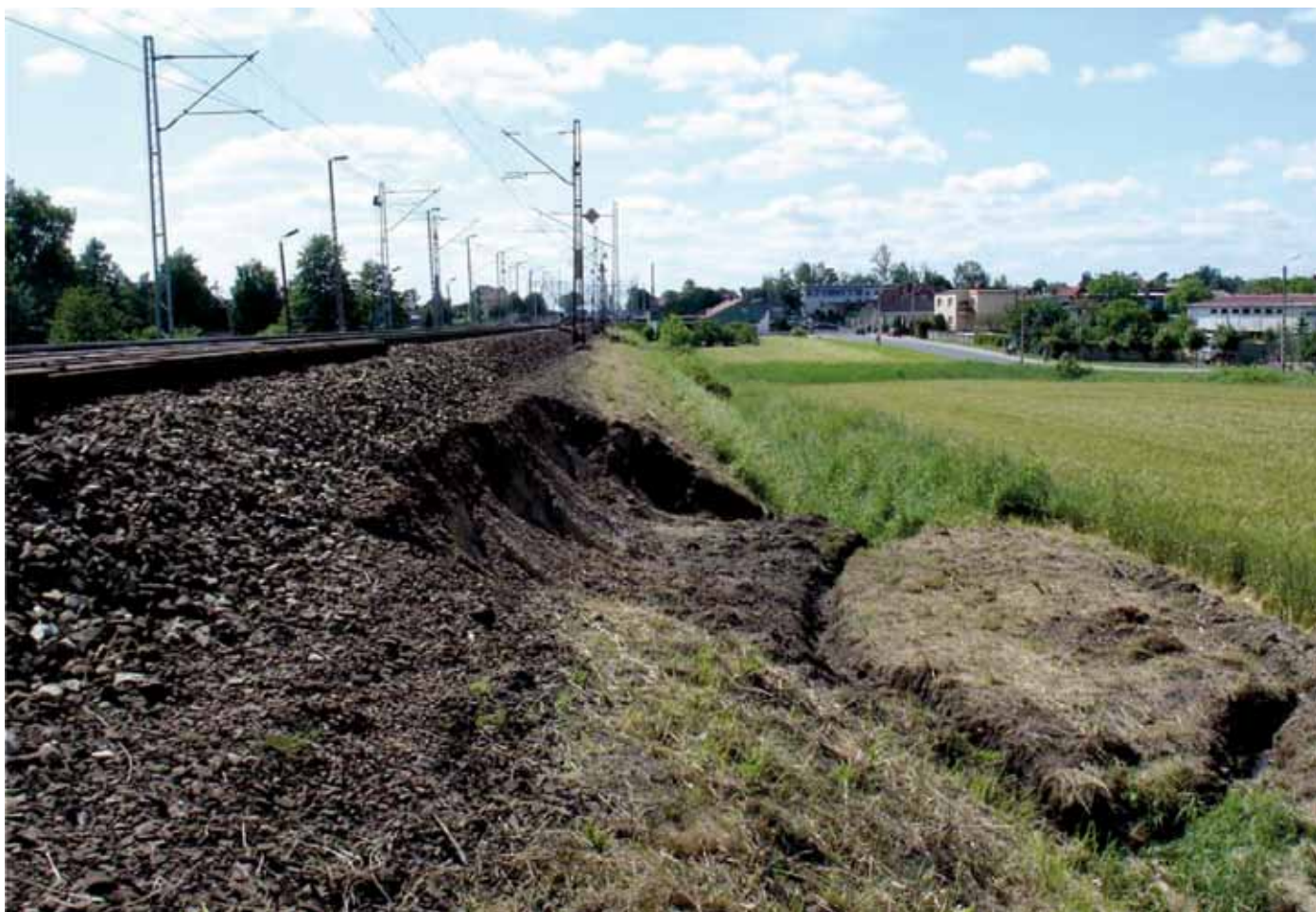
1. Osuwisko północnej skarpy nasypu, linia kolejowa E20, tor nr 1
