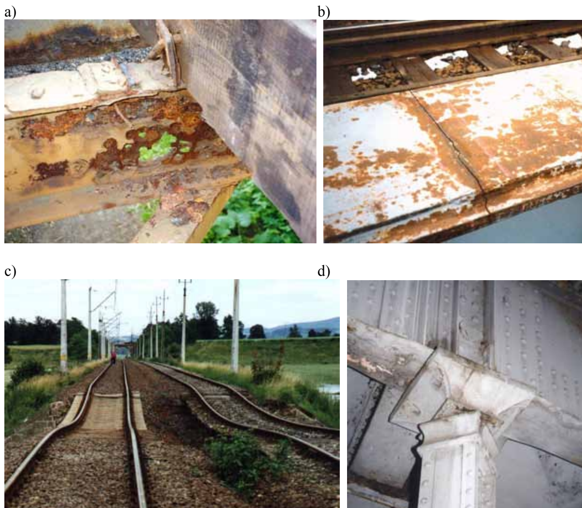
7. Przykłady stanów awaryjnych kolejowych obiektów mostowych: a) ubytki materiału podłużnicy, b) pęknięcie zmęczeniowe dźwigara głównego, c) deformacja konstrukcji w wyniku powodzi, d) zmiana położenia filara w wyniku kolizji
