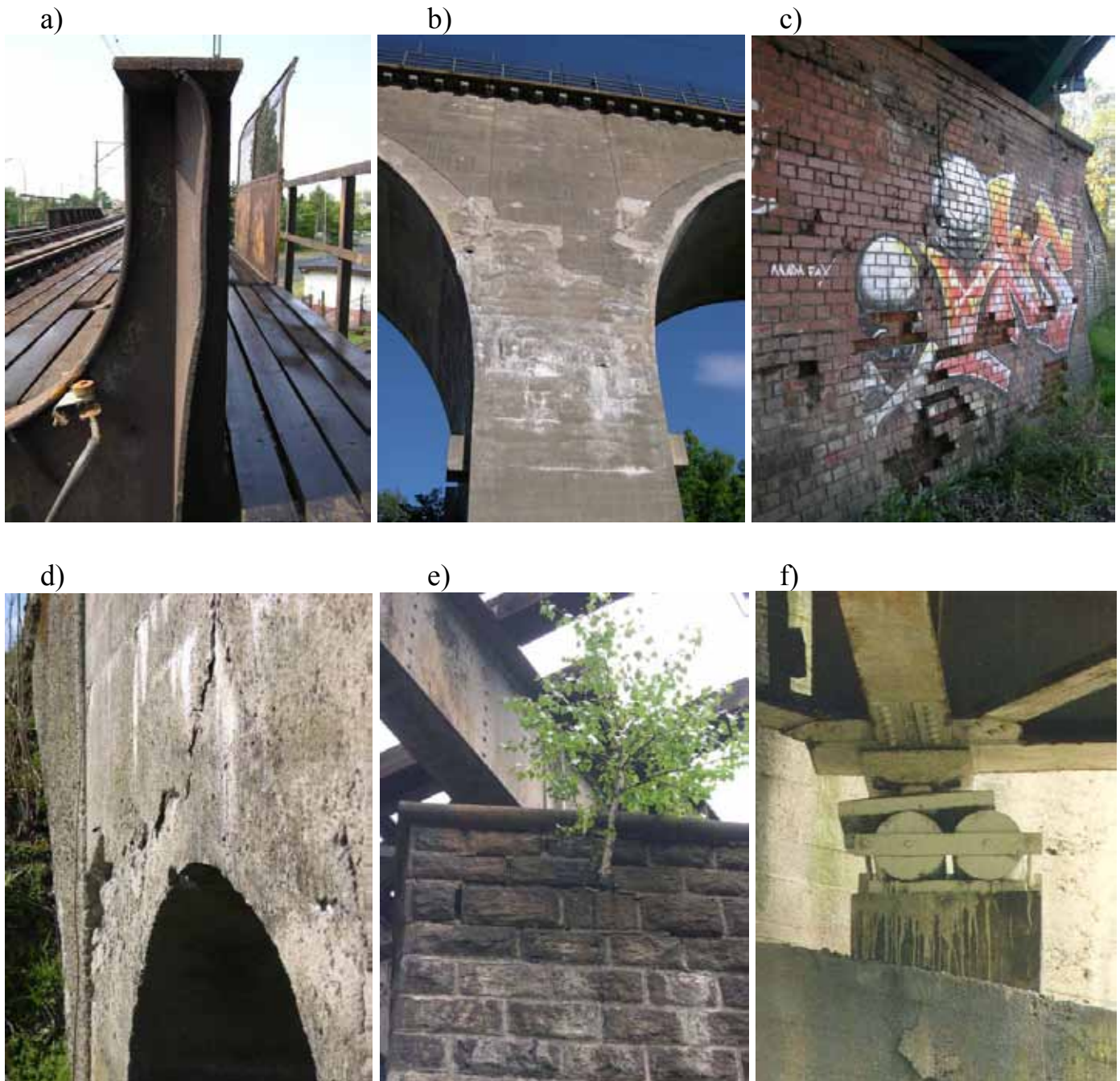
5. Przykłady podstawowych typów uszkodzeń kolejowych obiektów mostowych:
