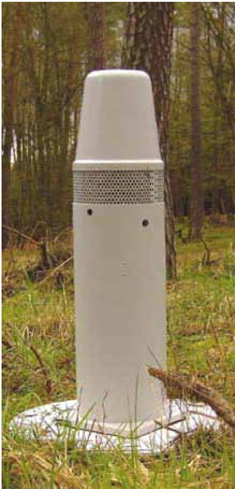
2. Urządzenie (wieża) UOZ-1 na magistrali E-20 Mińsk Mazowiecki-Siedlce UOZ-1 [3], fot. Bombardier
