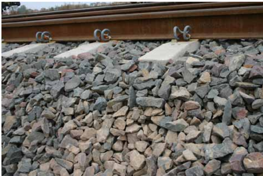
8. Zabrudzony tłuczeń (widoczne przebarwienia na kruszywie na dole zdjęcia)
