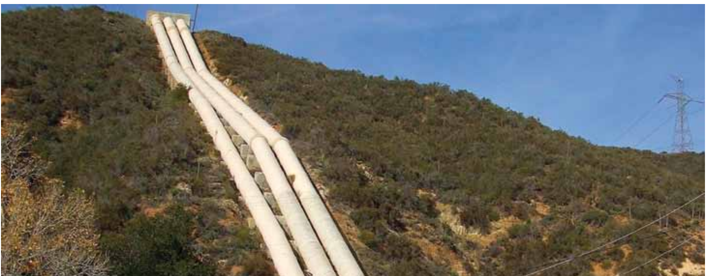
19. Woda dla Los Angeles - rurociągi i stacje pomp
