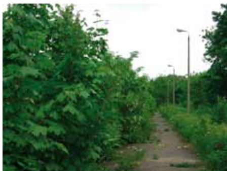
3. Zarośnięty peron nieczynnego p.o. Zegrze
