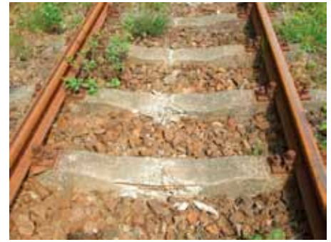
6. Mechaniczne uszkodzenie podkładów
