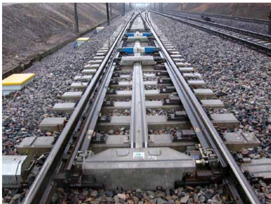
3. System HYDROSTAR na stacji Włoczek Północ
