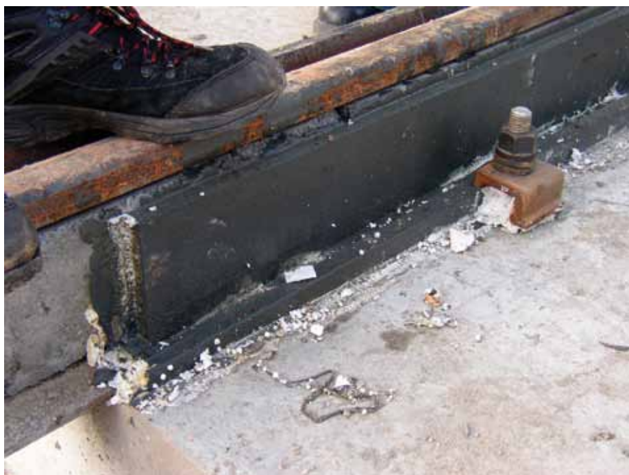
2. Zastosowanie bloczków betonowych w komorach szyn, przytwierdzenie szyn do podbudowy łapkami Łp3 – tanie materiały kosztem trwałości.
