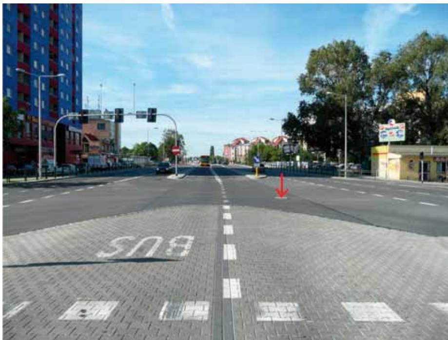
10. Widok z przystanku Nowy Dwór Krzyżówka w kierunku ul. Rogowskiej. Strzałką zaznaczona studzienkę kanalizacyjną w pasie toru tramwajowego. Opracowanie własne
