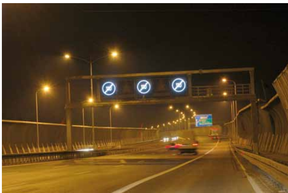
14. System Informacji Autostradowej - Bramownice z zestawami znaków zmiennej treści
