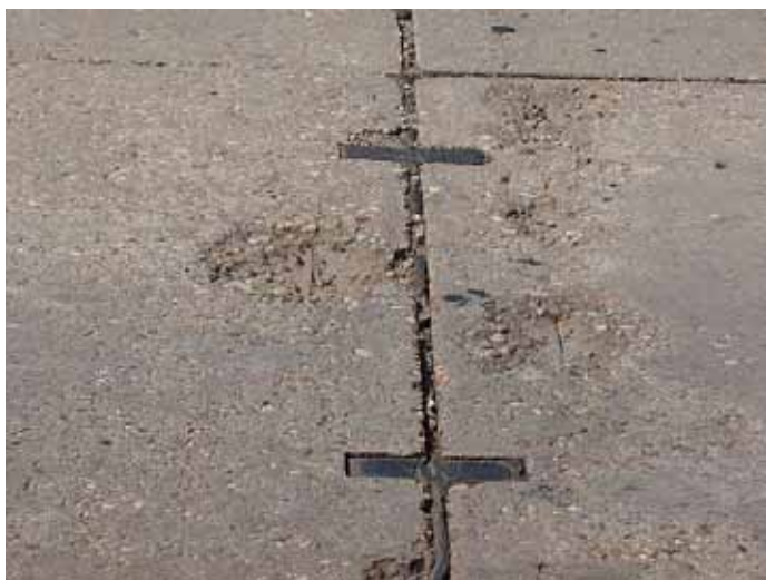
4. Słaba jakość wykonania płyt EPT i nieuszczelnienie szczelin
