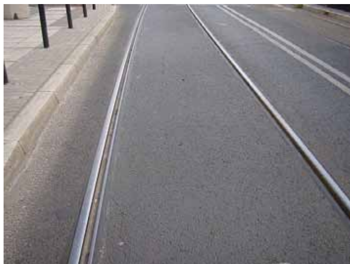
24. Błędy utrzymaniowe, brak zalania mikropęknięć w nawierzchni
