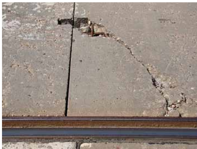
3. Zaniedbania wykonawcze skutkowały pękaniem naroży płyt i natychmiastowym efektem klawiszowania
