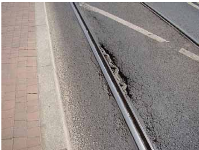
23. Błędy wykonawcze popełnione przy wykonywaniu szczelnego połączenia pomiędzy nawierzchnią a szyną
