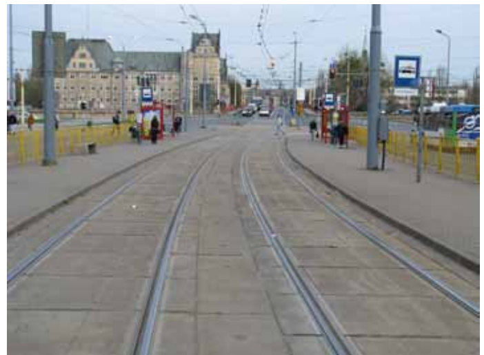
11. Nawierzchnia asfaltowa z bardzo dużymi odształceniami i głębokimi ubytkami w górnej warstwie (natężenie autobusów ponad 30 A/h)
