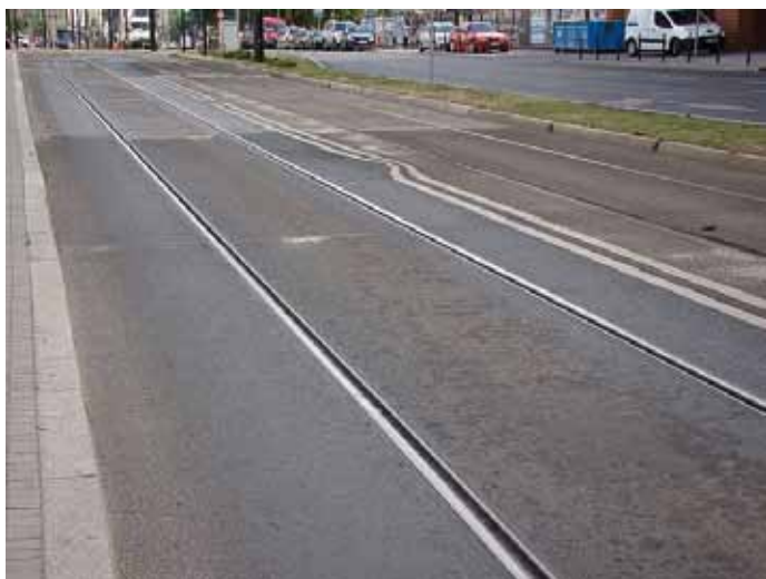
12. Garby i fałdy podłużne tworzące się na nawierzchni pasów autobusowo-tramwajowych, wskutek bardzo częstego hamowania autobusu bezpośrednio przed skrzyżowaniem z sygnalizacją świetlną
