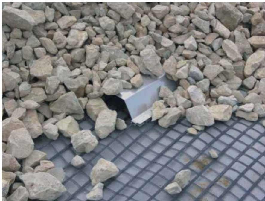
8b. Fotografia czujnika w obudowie podczas zasypywania kruszywa w czasie testowania rozwiązań technicznych systemu w ramach poletka doświadczalnego
