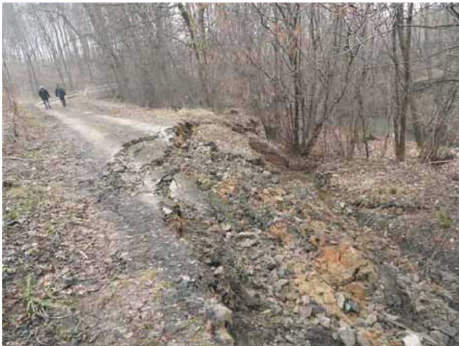
3. Zniszczona w wyniku osuwiska droga
