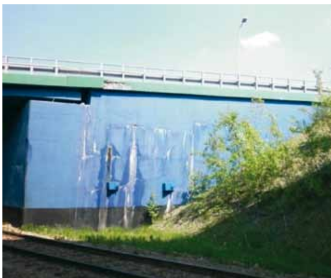
22. Uszkodzenia „starego” wiaduktu – stan na rok 2011
