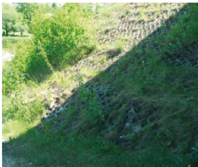
23. Deformacje występujące na płytach ażurowych skrzydełek „starego” wiaduktu – stan na rok 2011
