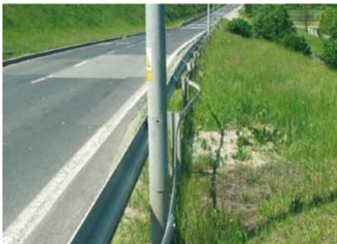
20. Widok na skarpę zdeformowane barierki energochłonne i nawierzchnię „starego” nasypu – stan na rok 2011
