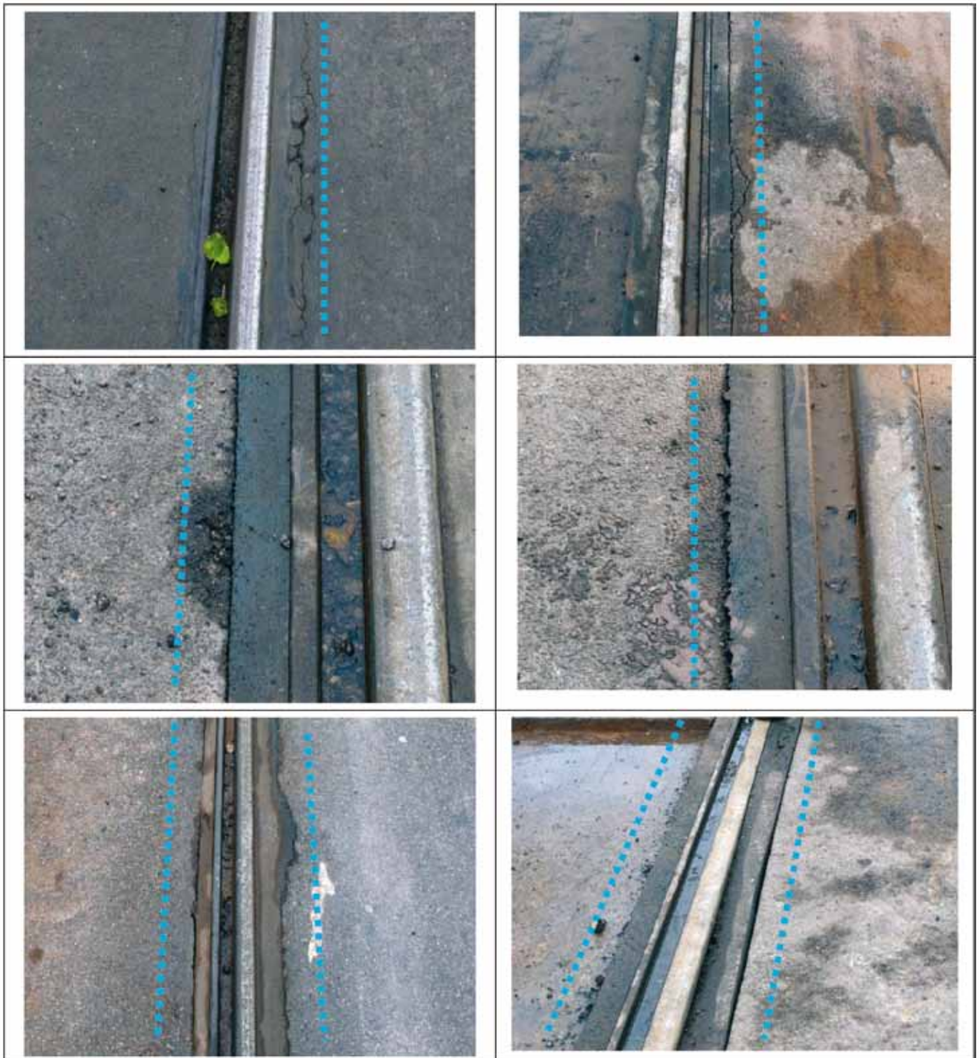
7. Przykłady wad grupy B w bitumicznej warstwie zabudowy
