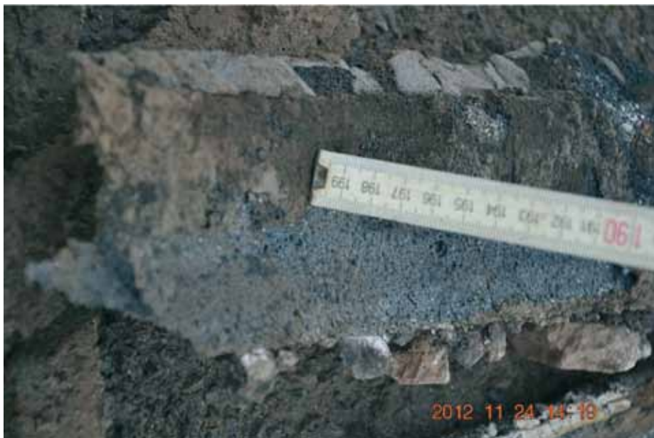
10. Uszczelniająca masa zalewowa – widoczna nieregularna porowatość jej struktury.
