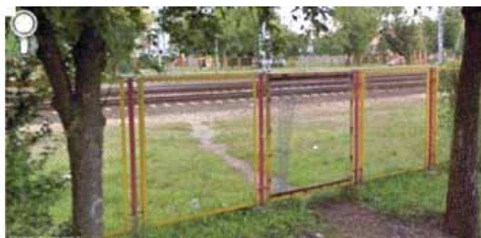
5. Zdewastowane ogrodzenie po obu stronach torów
