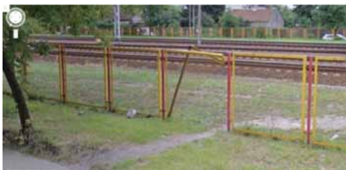
4. Zdewastowane ogrodzenie po obu stronach torów
