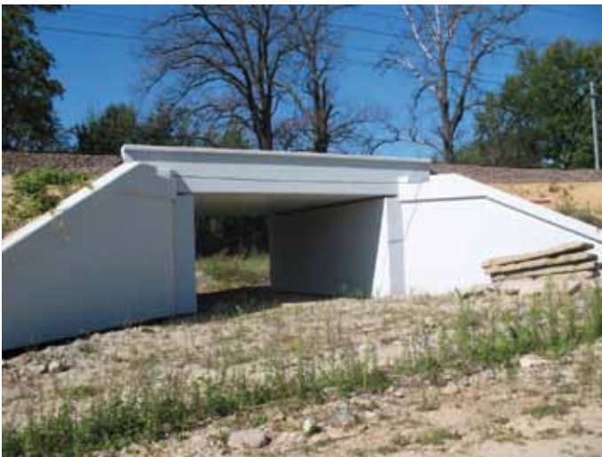
5. Przejście dla zwierząt pod torami w km 24+800. Obiekt ekologiczny, nowoprojektowany, przęsła stalowe z dźwigarów obetonowanych.
