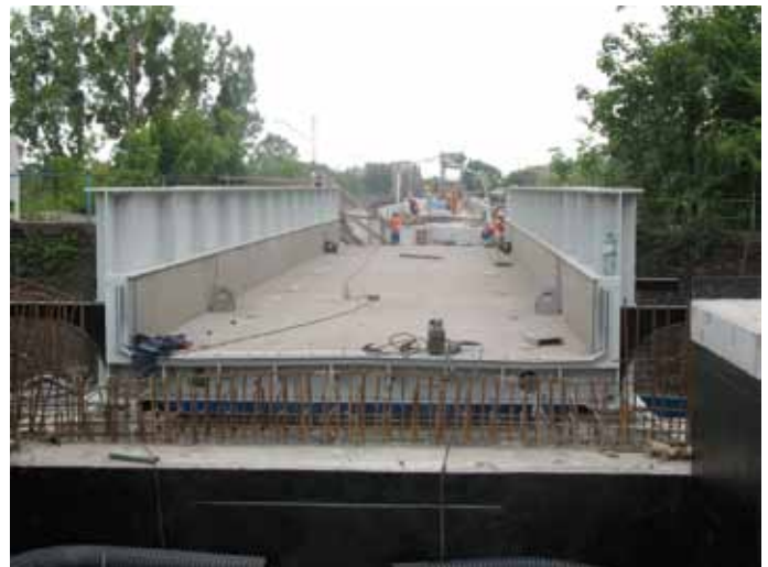
2. Wiadukt kolejowy w km 6+111 nad ul. Osobowicką we Wrocławiu. Przęsło stalowe, z korytem balastowym. W tle most przez Odrę w km 5+845 z estakadami dojazdowymi
