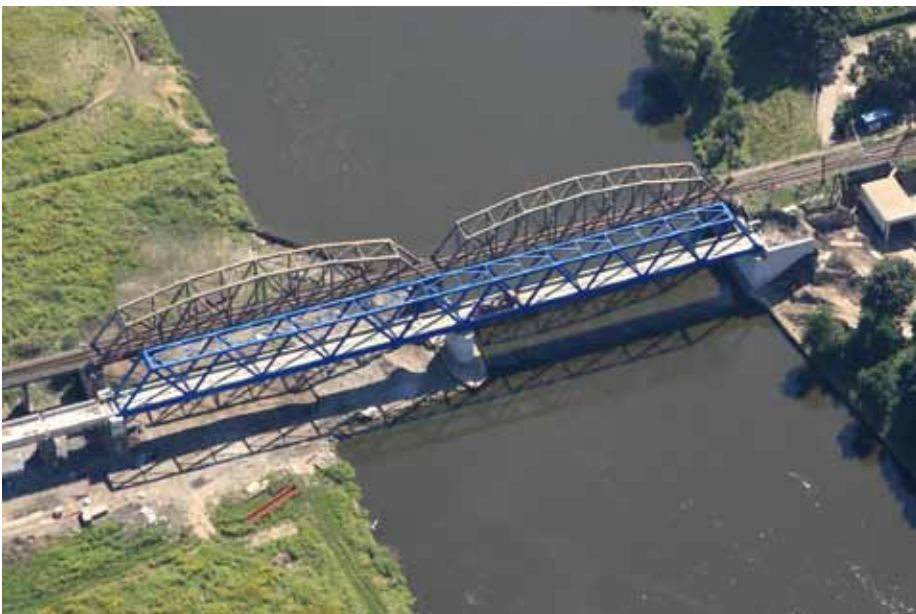
12. Widok z lotu ptaka nowej konstrukcji, po jej nasuwie w położenie docelowe. [9]
