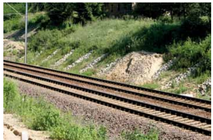
2. Skarpa nieumocniona humusowaniem porośnięta roślinnością. Prowizoryczne uzupełnienie i dociążenie skarpy osuwiska piaskiem.
