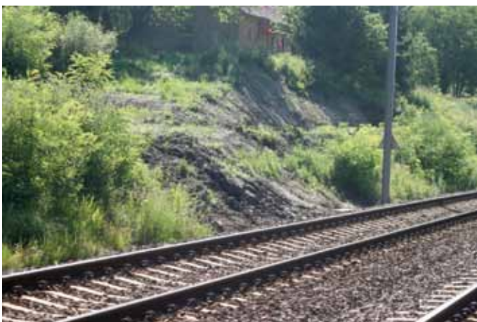
1. Widok na odkrytą powierzchnię skarpy po osuwisku. Niebezpieczne zbliżenie do budynku. Droga robocza z miejscowymi zastoinami wody.
