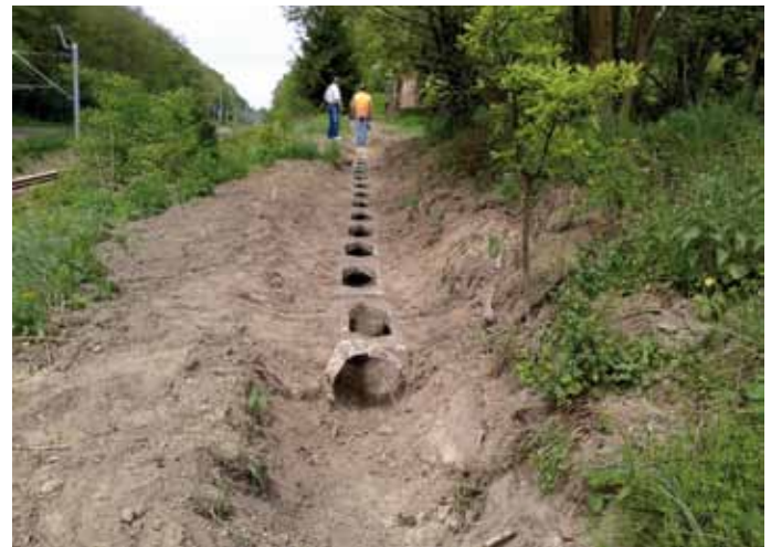
4. Stary drenaż betonowy na szczycie skarp.
