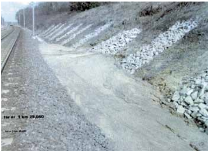
3. Wypłukany piasek spod sączków kamiennych. (zdjęcie Zakładu linii kolejowych PKP PLK S.A.)
