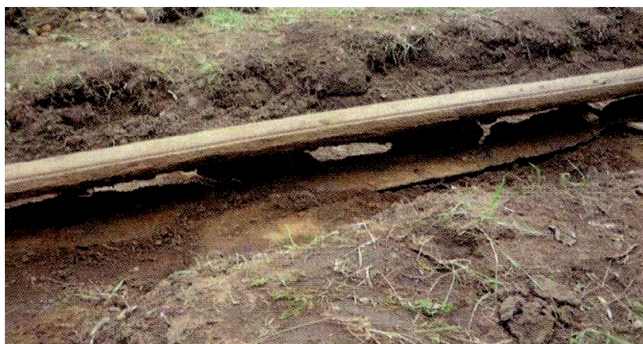
4. Korozja uszkodzenia szyjki szyny tramwajowej po odkopaniu otaczającej szynę ziemi (pseudo zielone torowisko).
