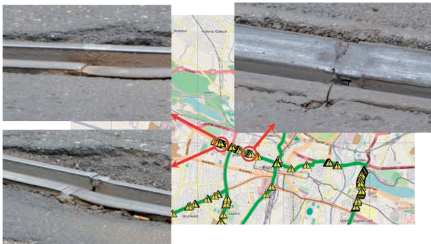
6. Nieciągłości kolejnych sekcji szyn w ciągu ulicy Dąbrowskiego
