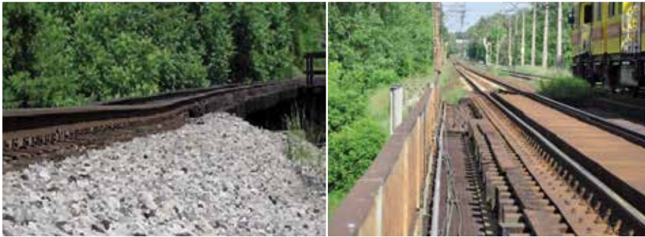
3. Przykłady deformacji w strefie przejściowej na dojeździe do obiektu inżynierskiego
