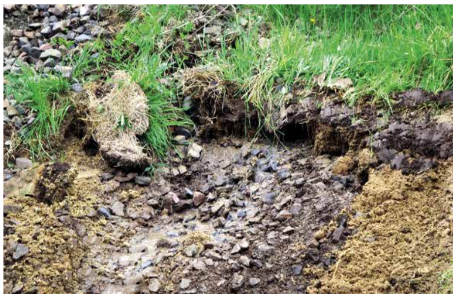
3. Przykład wypływu wody ze skarpy
