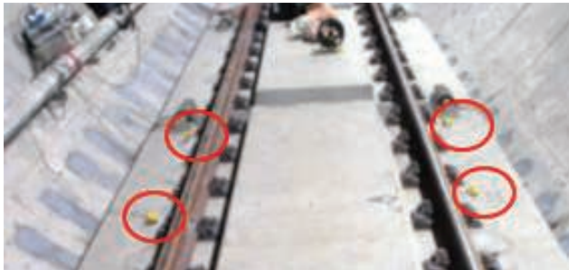
11. Lokalizacja czujników pomiarowych na płycie betonowej z systemem wibroizolacji sprężynowej na linii metra nr 10 w Szanghaju
