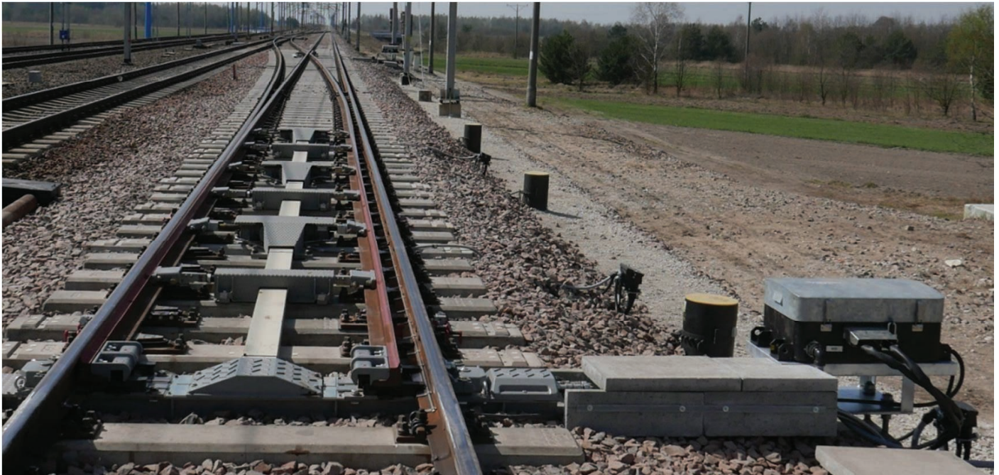
3. Zwoznica rozjazdu R2500 z napędem hydraulicznym Alstom SmartDrive. Źródło: Track Tec.
