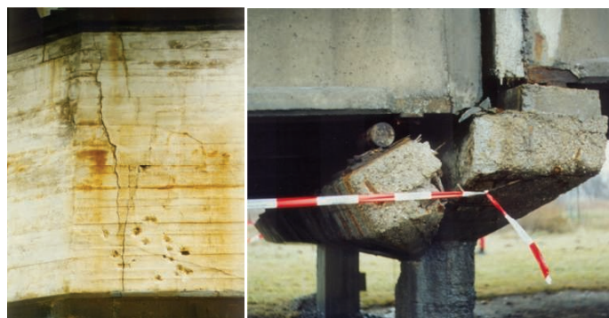
13. Utrata ciągłości materiału: rysy (po lewej) oraz pęknięcie (po prawej)
