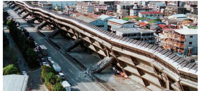
15. Zmiana położenia (obróć) całej konstrukcji mostowej w wyniku trzęsienia ziemi, połączona z deformacjami oraz ubytkami i utratą ciągłości materiału
