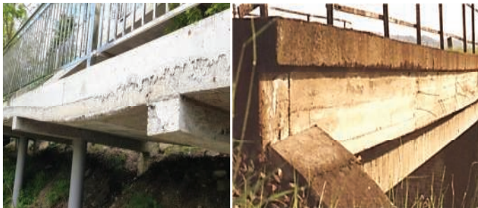
10. Deformacje w postaci: nieprawidłowej geometrii konstrukcji (po lewej) oraz zmiany geometrii osi elementu - trwałe wygięcie konstrukcji przęsła (po prawej)
