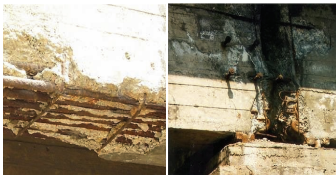
12. Ubyteki betonu warstw zabezpieczających oraz ubytki stali zbrojeniowej dźwigarów mostowych
