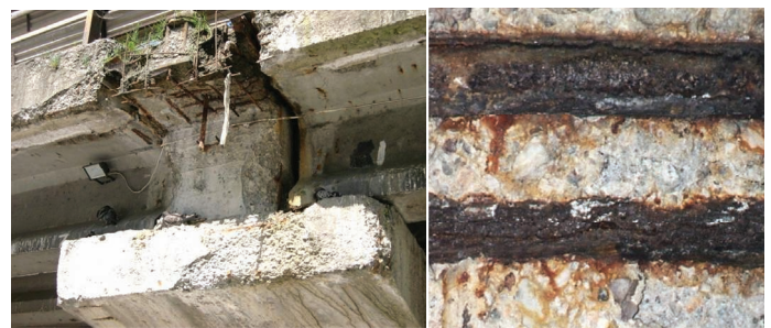
11. Destrukcja betonu i stali prętów zbrojenia w postaci pogorszenia cech chemicznych i fizycznych materiałów – występująca równocześnie z ubytkami materiału
