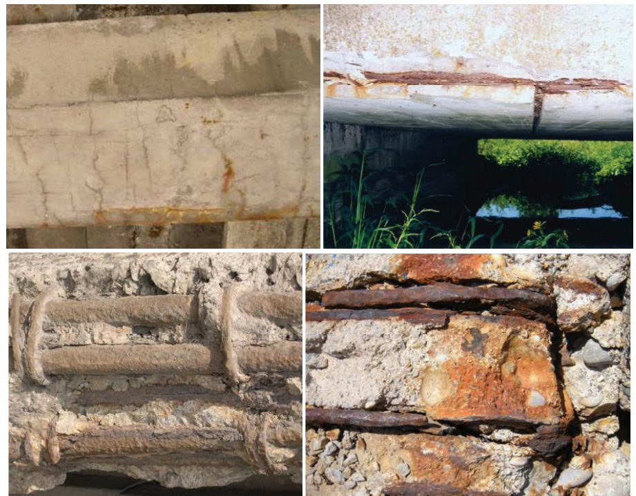
5. Charakterystyczne skutki procesów korozyjnej degradacji konstrukcji żelbetowych: a) zarysowania otuliny i wycieki produktów korozji zbrojenia, b) pęknięcia i odspojenie otuliny, c) ubytki otuliny i odsłonięcie prętów zbrojenia, d) ubytki materiału prętów zbrojenia prowadzące do przerwania ich ciągliwości
