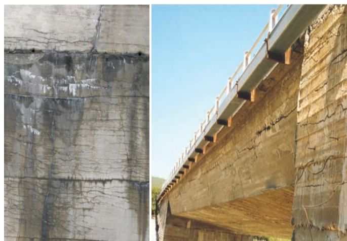
7. Przykłady efektów destrukcyjnej degradacji materiału: zarysowania i destrukcja betonu spowodowane cyklicznym zamarzaniem/odmarzaniem wody i wymywaniem składników betonu (po lewej) oraz skurczem betonu (po prawej)
