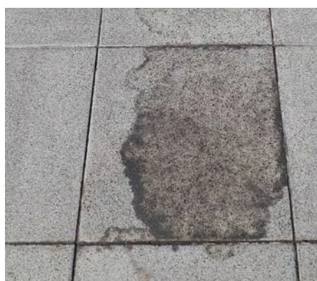
13. Przykładowe trwałe zanieczyszczenia elementów nawierzchni
