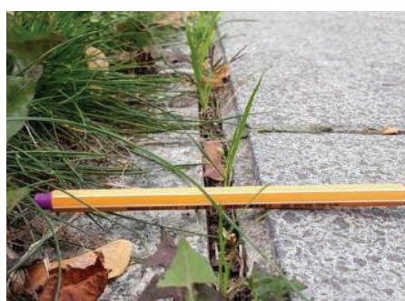
14. Przykładowe zapadnięcia/przesunięcia krawężników
