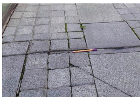
12. Przykładowe wyparcia masy uszczelniającej
