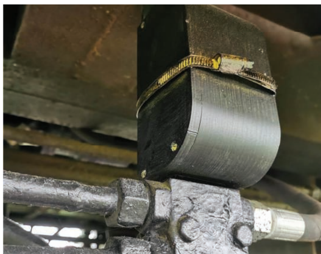
3. Miejsce montażu nadajnika na wózku motorowym typu WM-15A
