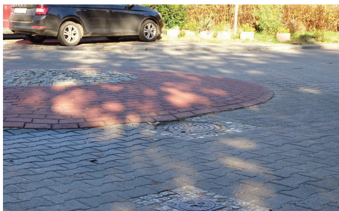
21. Osiadanie nawierzchni wokół wjazdu na skrzyżowaniu ul. Wiejskiej z ul. Mieszka I
