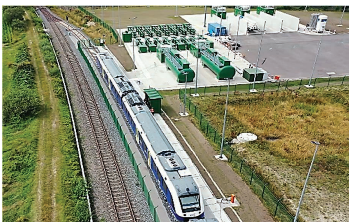
2. Przykład stacjonarnej stacji tankowania wodoru przeznaczonej dla sektora kolejowego, Bremervörde, Niemcy. Źródło [6]
