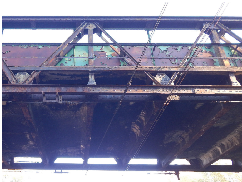
4. Niewłaściwie utrzymywany (brak przeprowadzanych prac konserwacyjnych) wiadukt nad koleją
