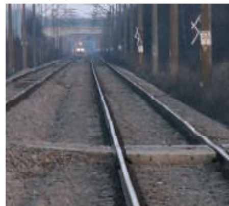
1. Fragment linii kolejowej o silnie zdeformowanych torach
