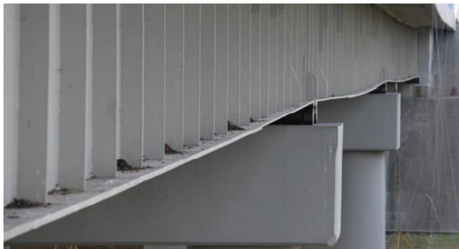
2. Trwałe ugięcia dźwigarów głównych przęseł
