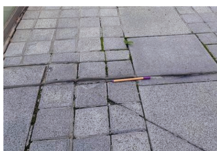
12. Przykładowe wyparcia masy uszczelniającej
