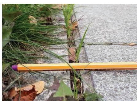
14. Przykładowe zapadnięcia/przesunięcia krawężników
