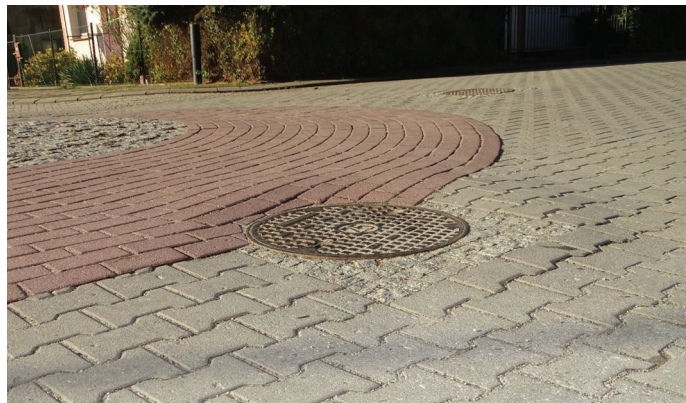
20. Osiadanie nawierzchni wokół wjazdu na skrzyżowaniu ul. Wiejskiej z ul. Krzywoustego
