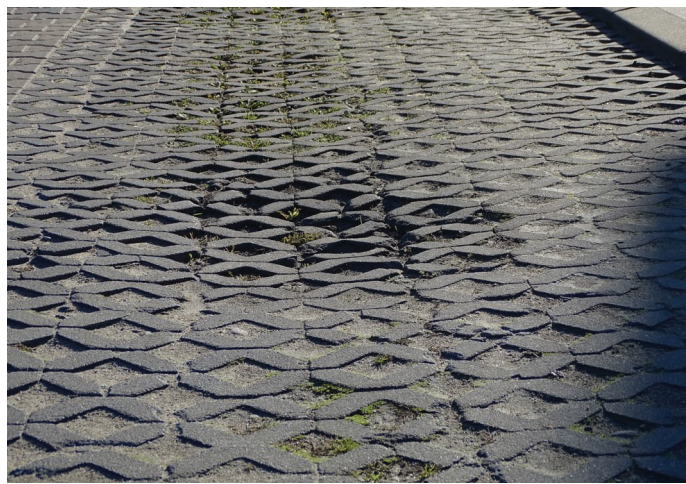
17. Osiadanie i degradacja płyty betonowej ażurowej na pasie postojowym
